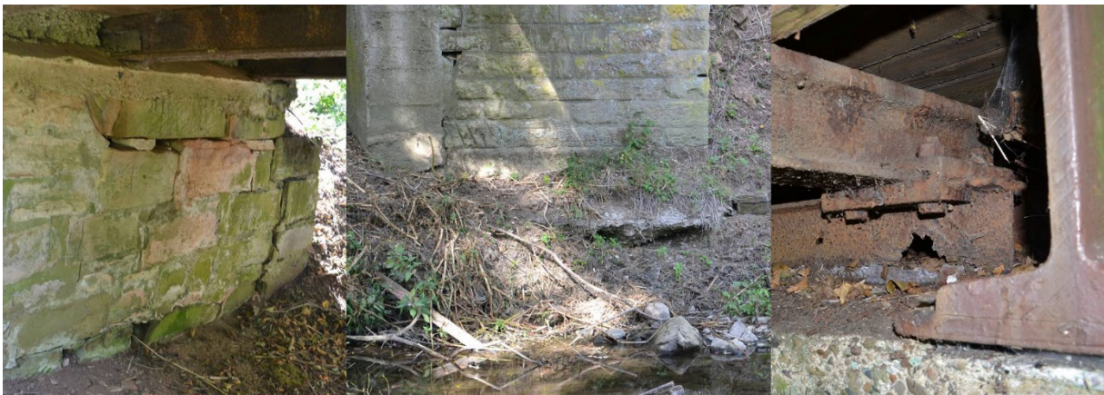
Detailaufnahmen aus dem Gutachten des Büros Pfeiffer X Schmidt vom 28.10.19
